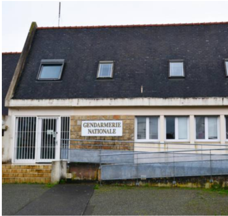
À Plabennec (en photo) et à Lannilis, les bâtiments des gendarmeries sont insalubres. Le conseil communautaire a acté la construction de deux nouvelles.
