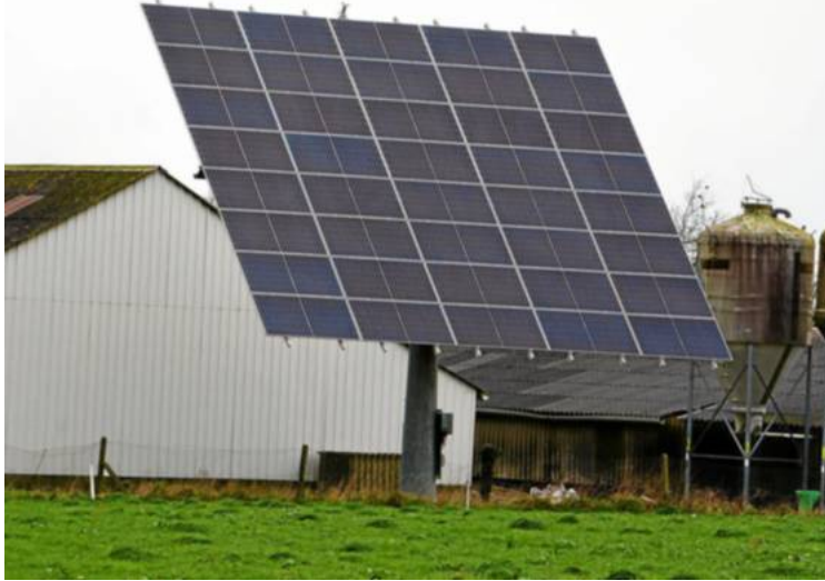
Le photovoltaïque au sol se traduit par des « trackers solaires » comme celui-ci, implanté dans une exploitation du territoire.
