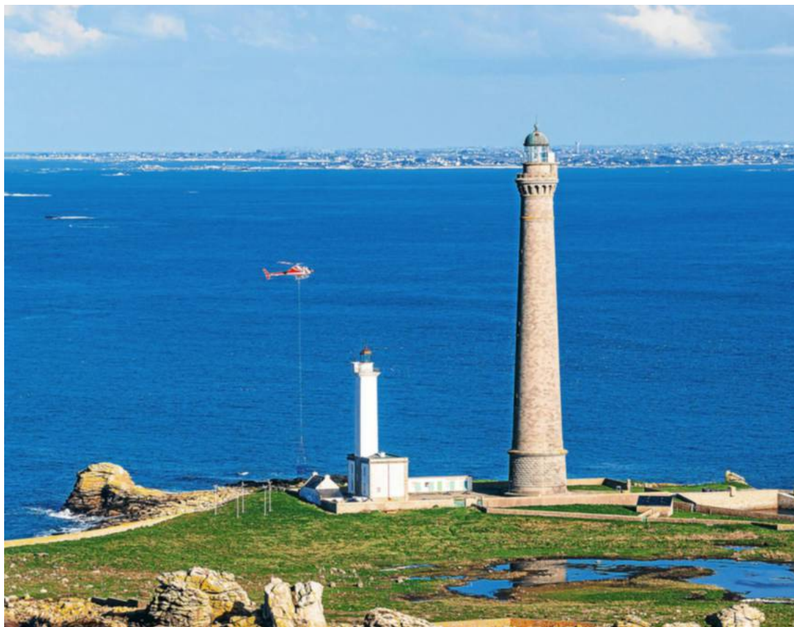
L'hélicoptère a assuré 50 rotations, lundi. 50 tonnes d'équipement (échafaudages, outillage, matériaux...) auront été débarquées. Place au chantier de restauration de la salle de veille des gardiens du grand phare de l'île Vierge. Le Télégramme/Abers tourisme
